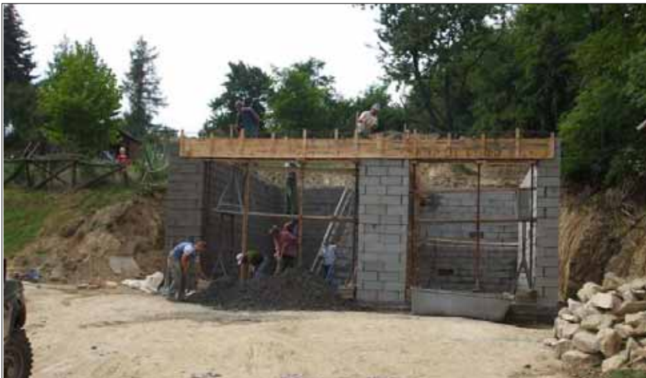
Az óvoda és a posta közötti területen földbesüllyesztett garázs épül, amely fűtést majd nem igényel
